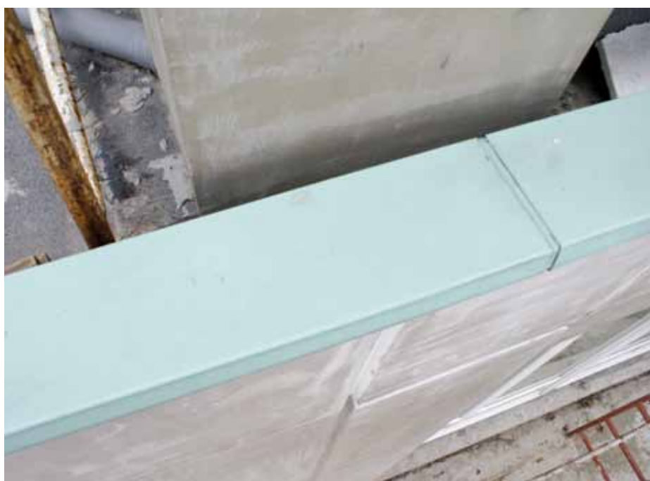
▲ Dylatacja w obróbce
